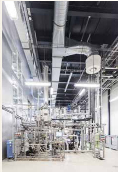
Fraunhofer CBP Pilotanlage Quelle: © Norbert Michalke
