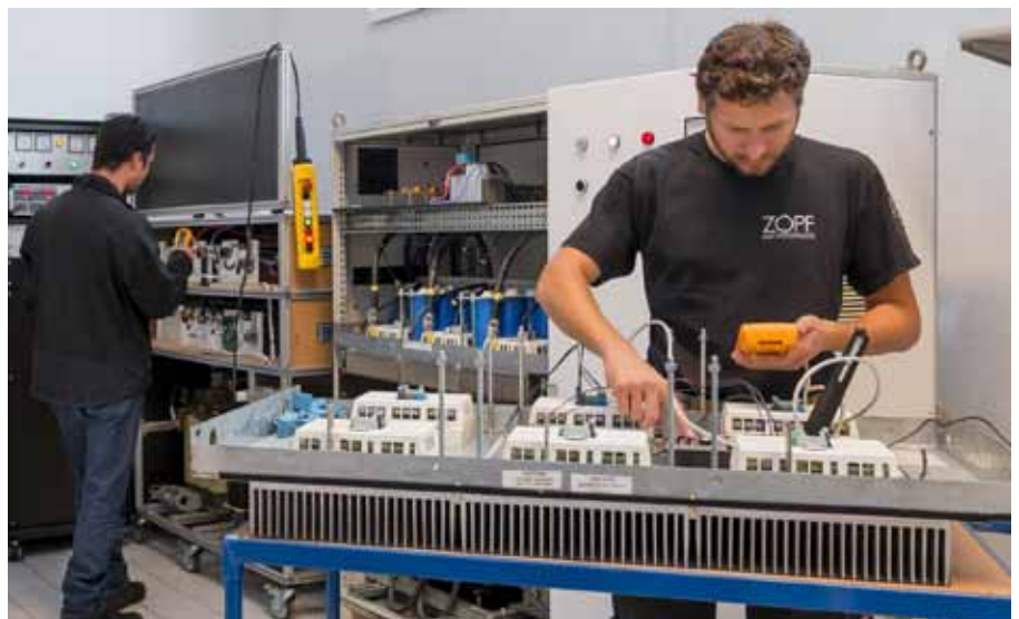
Instandsetzung eines Frequenzumrichters durch Mitarbeiter der ZOPF Energieanlagen GmbH. Quelle (2): ZOPF Energieanlagen GmbH
